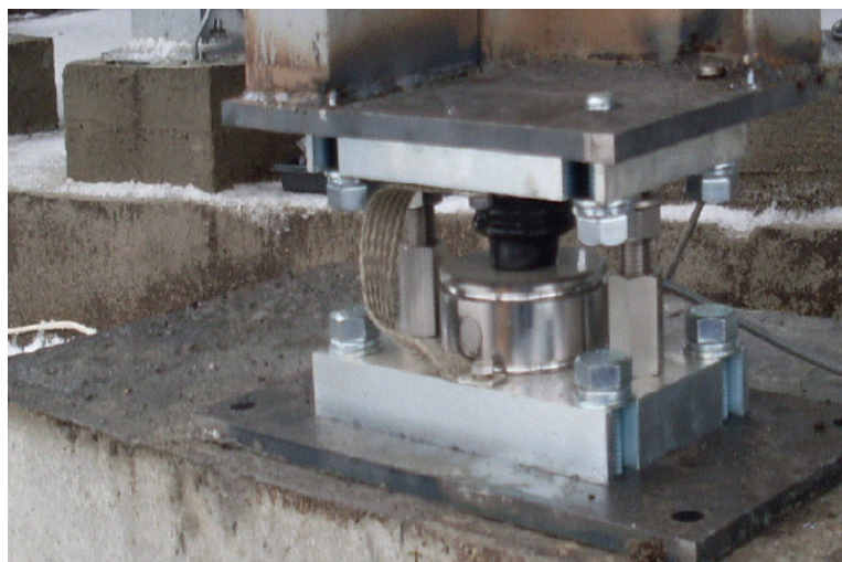
Obr. 1 Instalovaný tenzometrický snímač pod podpěrou
